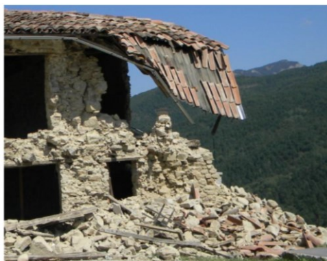
Fig. 1 - Comportamento di tipo disgregativo di una muratura di pessima qualità vicino ad Accumoli (RI) nel sisma del 24 agosto 2016
