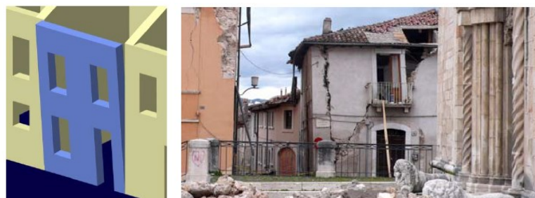
Fig. 17 - Ribaltamento di più livelli di parete causato dall'inefficace collegamento tra parete e orizzontamento
