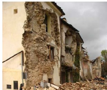
Fig. 26 - Flessione verticale di parete che interessa solamente il paramento esterno
